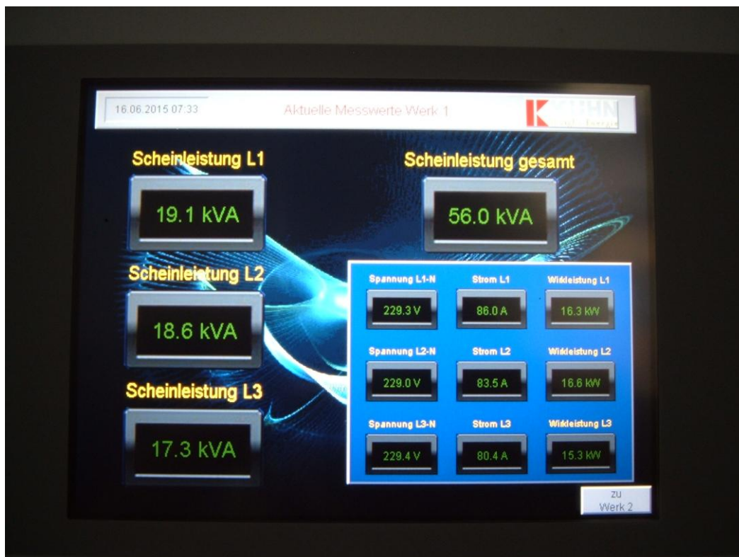
Bild2: Das Energie-Kontrollsystem überwacht die gesamte Elektronik, (Foto: LILA)
