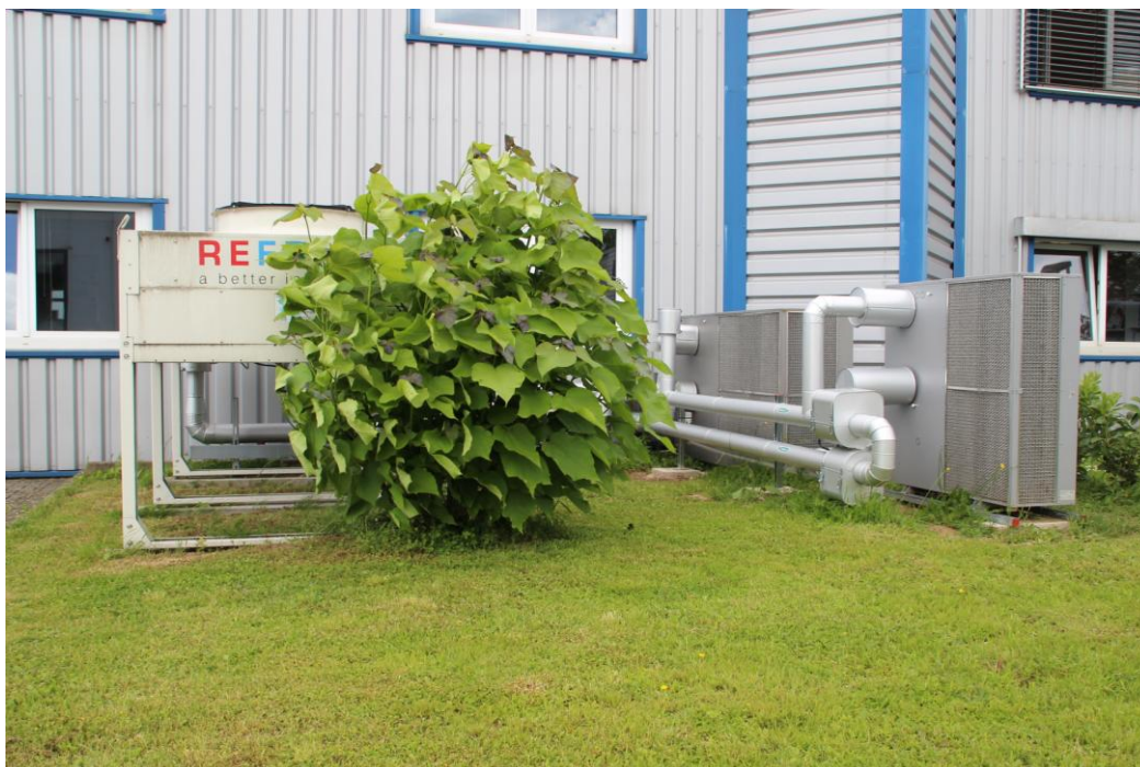
Bild1: Kaltwassersätze und Freikühler erzeugen die notwendige Prozesskälte (Foto: LILA)
